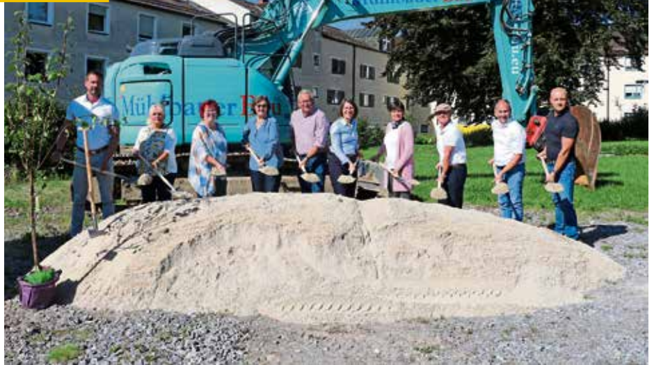
Sabine Rückle-Rösner, Vorständin der Diakonie Regensburg (4.v.l.) konnte zusammen mit Ehrengästen und Verantwortlichen der Baumaßnahme den offiziellen Spatenstich vollziehen Bild: Claudia Sprenger
